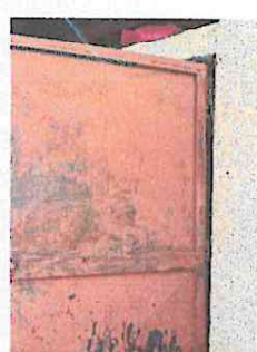
Foto 6: Deterioro en puertas de servicios sanitarios
