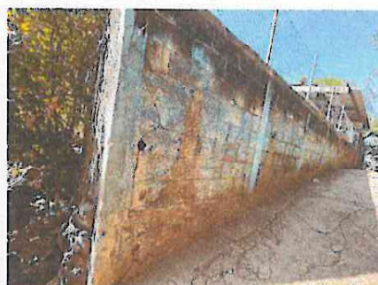
Foto 4: Daño y grietas en muro perimetral
