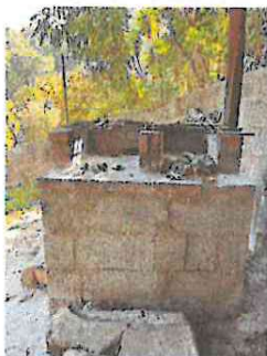
Foto 3: Estufa rural en mal estado
