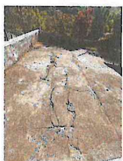
Foto 5: Grietas en planchas de concreto de patio
