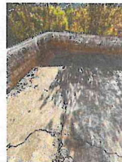
Foto 8: Fosa séptica, se encuentra de forma subterránea en el patio de la escuela
