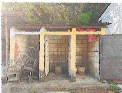
Foto 1: Deterioro de los sanitarios
